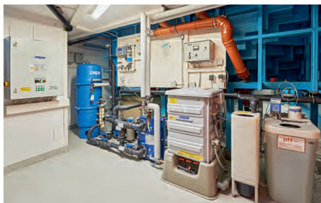
Die Ospa-Schwimmbadtechnik ist im Untergeschoss der Schwimmhalle direkt am Becken sauber und leicht zugänglich installiert.
