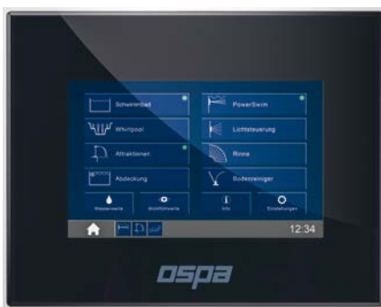
Display der Steuerung Ospa-BlueControl.
